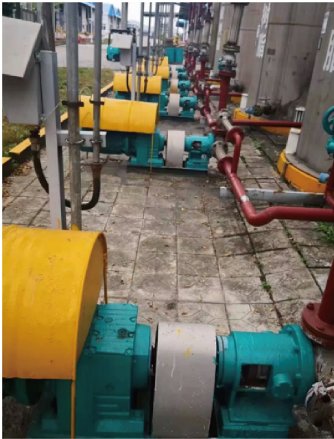
▲ 克尼罗瓦齿轮泵输送树脂现场
